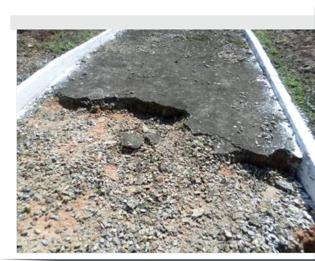
Piso da via principal danificado
