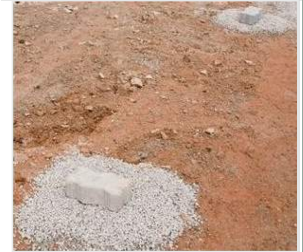
Execução (espalhamento, nivelamento e compactação) da camada de brita (preparação de sub-base/base)
